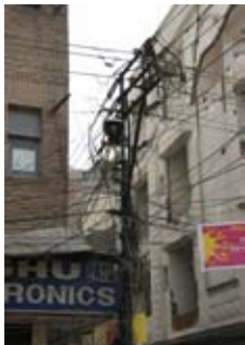
Tänk er att vara elektriker i Delhi.
