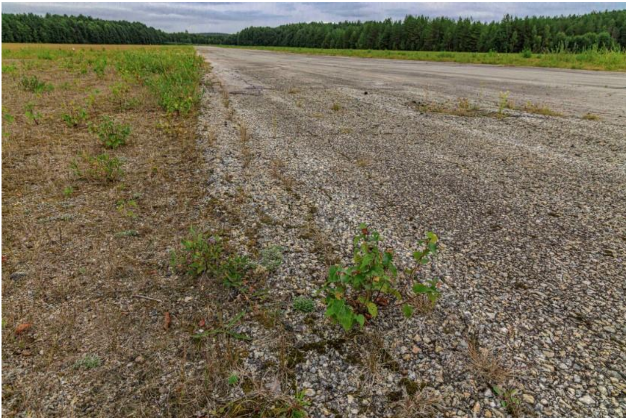
Bild 11. Vedartade växter kan med tiden bryta upp bankanten och banan som på sikt kan innebära en flygsäkerhetsrisk (åtgärd 2).
